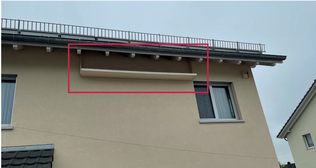
Abbildung 1: Ein Kotbrett (rot umrandet) unter Mehlschwalbennestern verhindert, dass Kot an Fenstern oder Fassaden landet.
